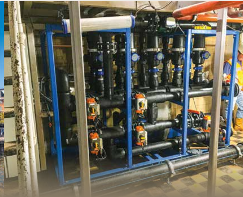
De Hydro Thermal Energy Skid, een compacte unit met pomp, filters, warmtewisselaar en verschillende meetapparatuur, werd in één dag opgebouwd.
